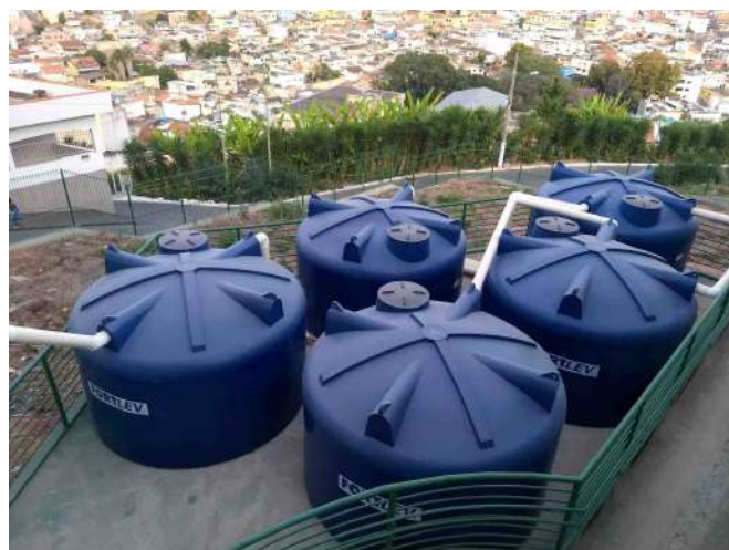
Figure 12: Três Corações Campus rainwater reservoir tanks.
