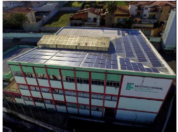
Figure 8: Campus Três Corações solar power plant.
