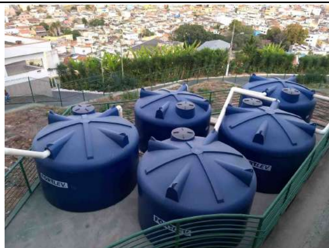
Figure 12: Três Corações Campus rainwater reservoir tanks.
