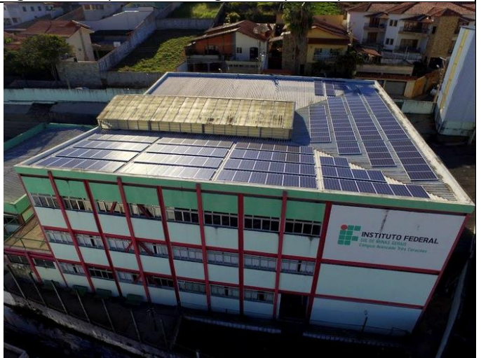
Figure 8: Campus Três Corações solar power plant.
