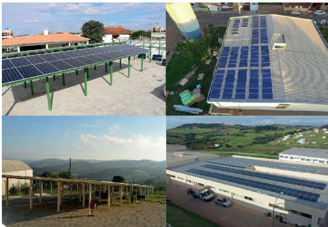
Figura 73 – Placas fotovoltaicas instaladas nas unidades do IFSULDEMINAS
