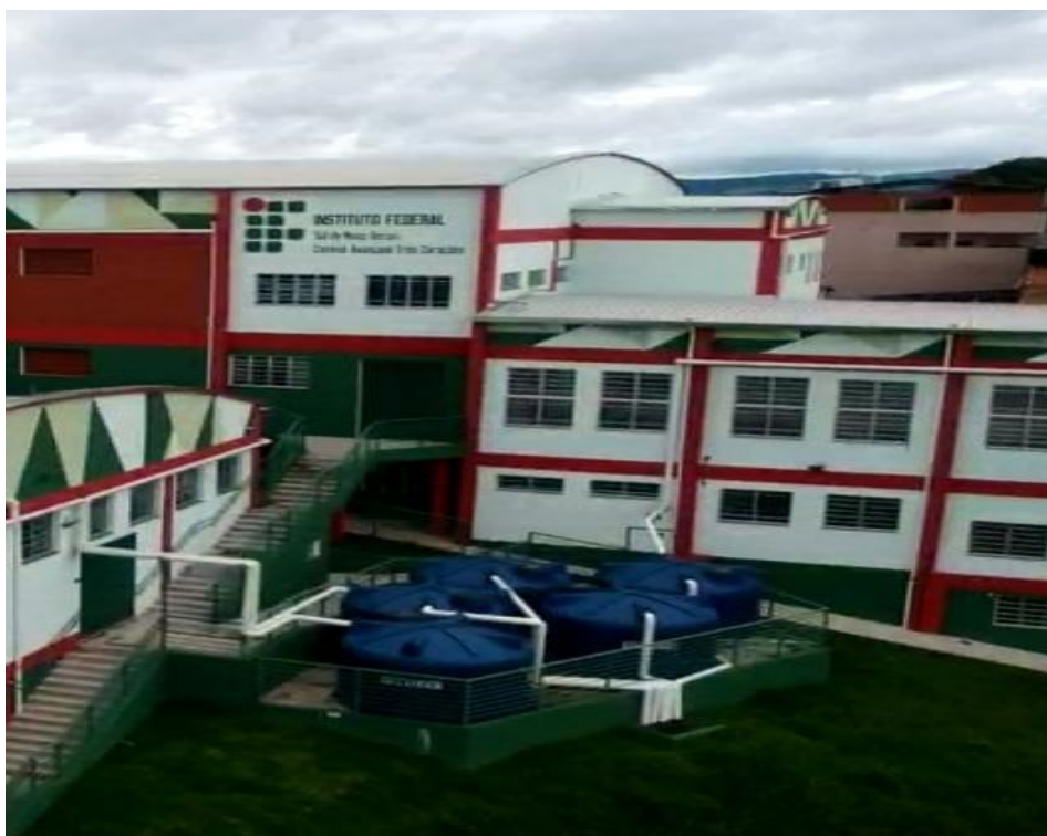
Figura 9 - Estação de coleta de águas pluviais (Campus II).
